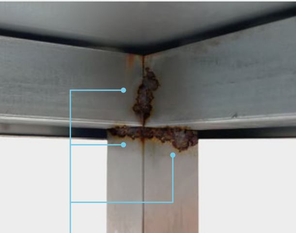
Oxidación por soldadura
